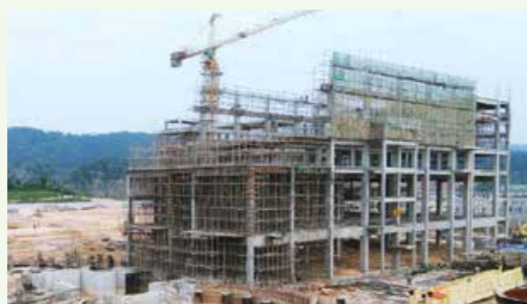
关丹联合钢铁项目采用了一系列由中国中冶研发的核心技术和装备，图为正在建设中的烧结冷却室，采用了烧结机综合密封技术、发电式环冷机及成套装备
